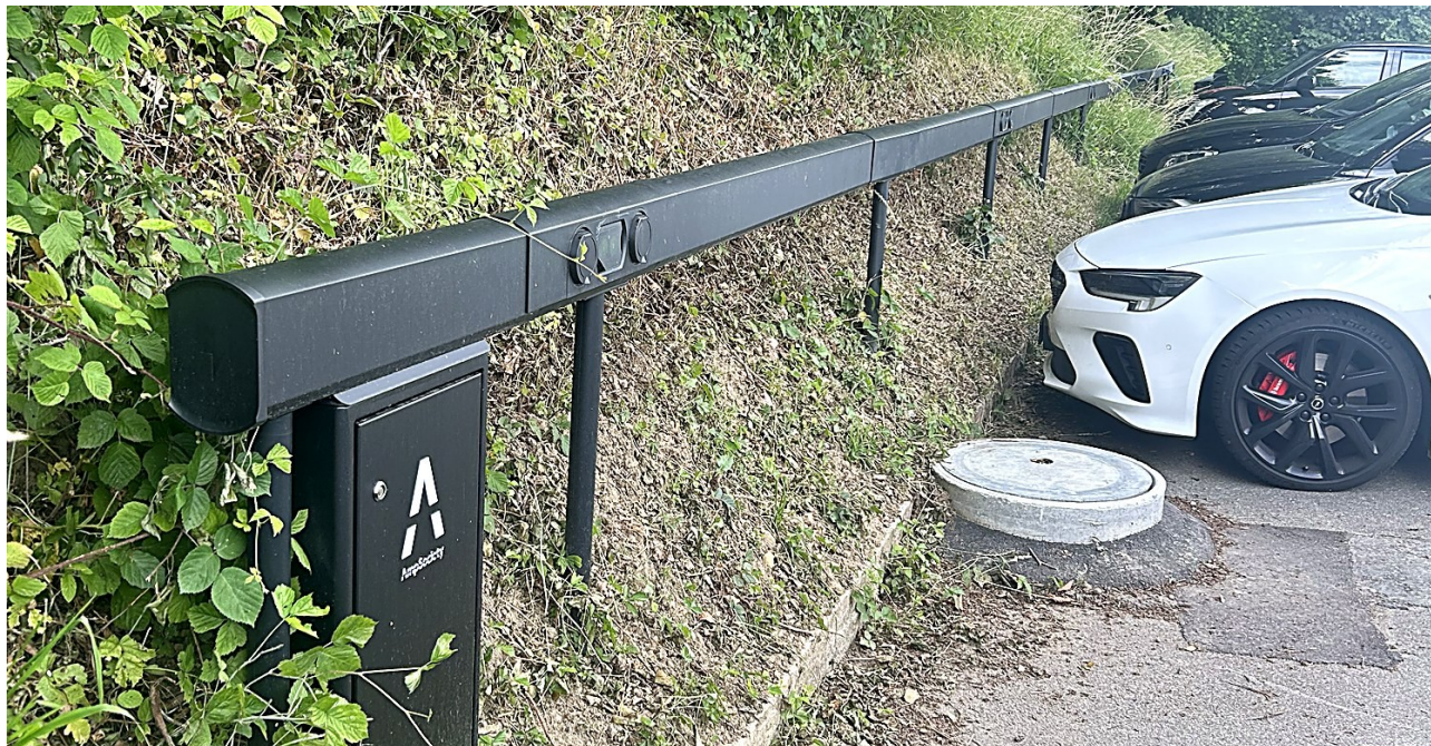
Installation AMP5 sur un parking extérieur (Ferratec)
