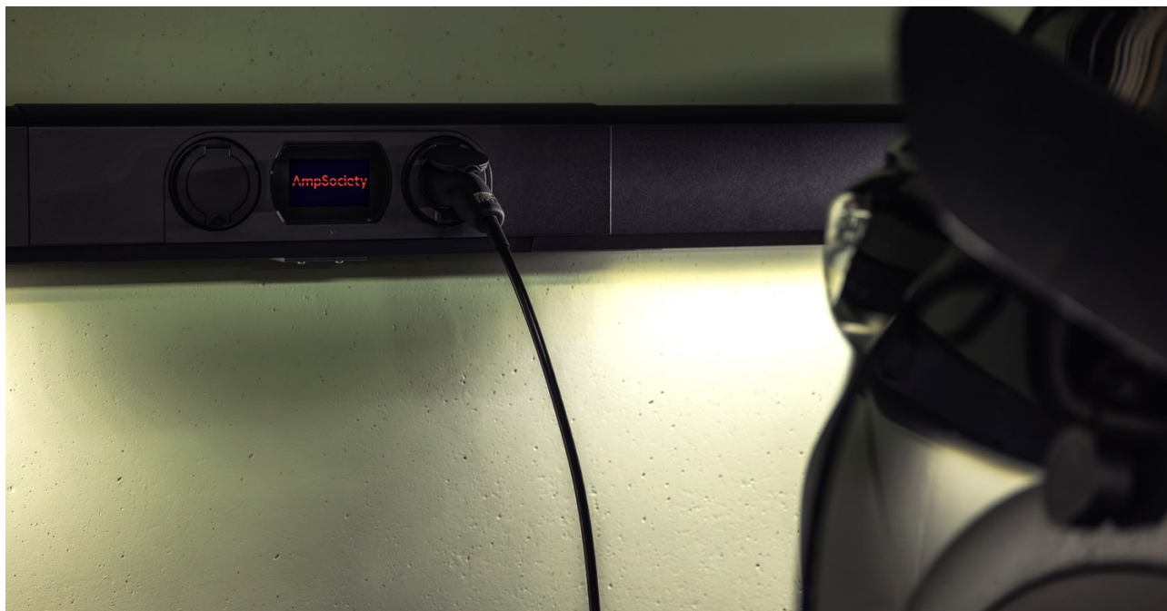
Système de recharge multipoint AMP5 dans un parking souterrain
